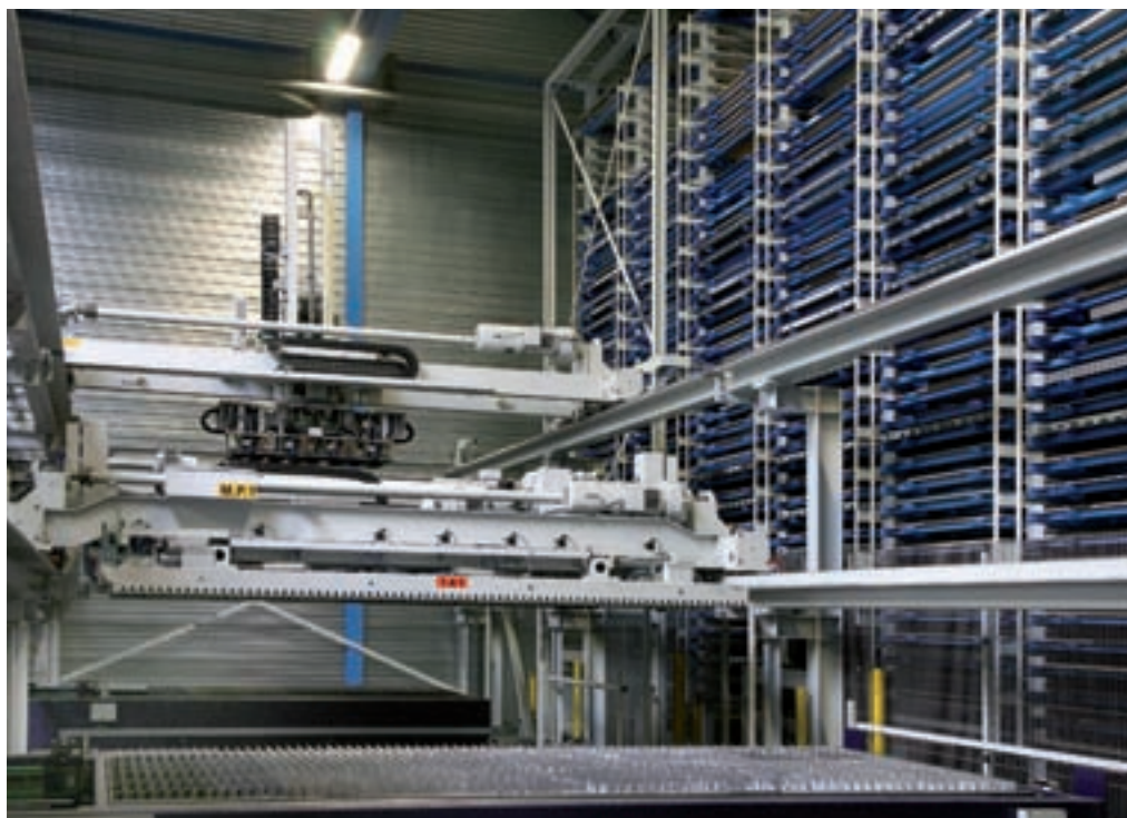
Speciale robots brengen de platen over van het magazijn naar de lasersnijmachines en vice versa.
