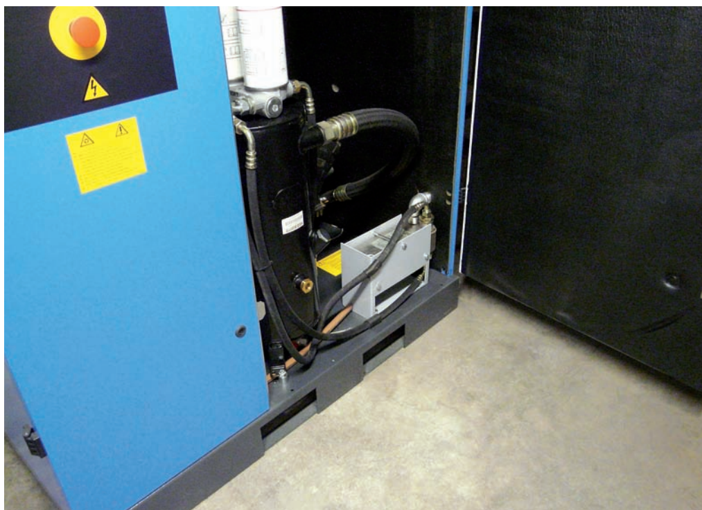
Deze ALUP Allegro 22 compressor (in gebruik bij Pally Biscuits) is voorzien van een warmtewisselaar in het oliekoelcircuit.
