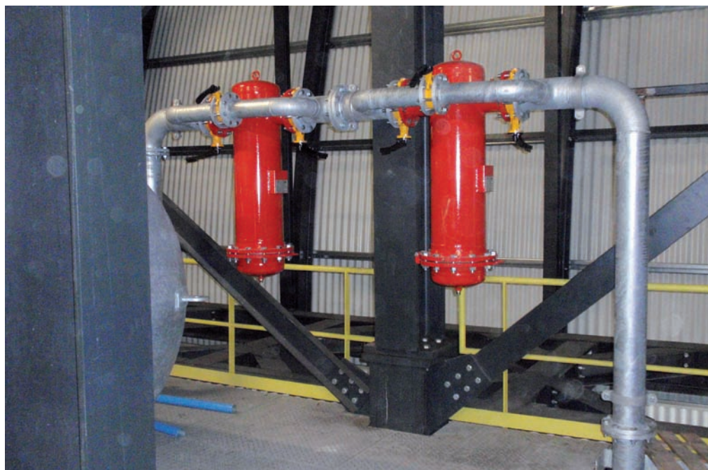
Het persluchtsysteem bij Maxit in Eindhoven is recent compleet vernieuwd.
