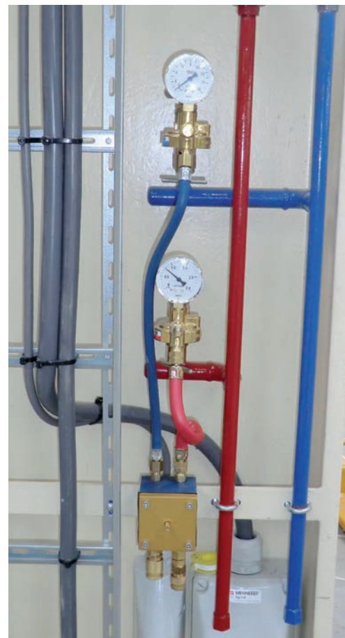
Wandaansluiting bij IHC Merwede, Kinderdijk.
