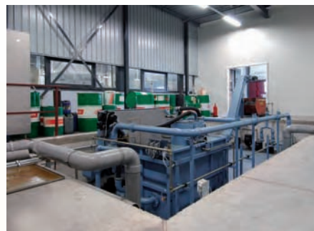
Het centrale filtersysteem
