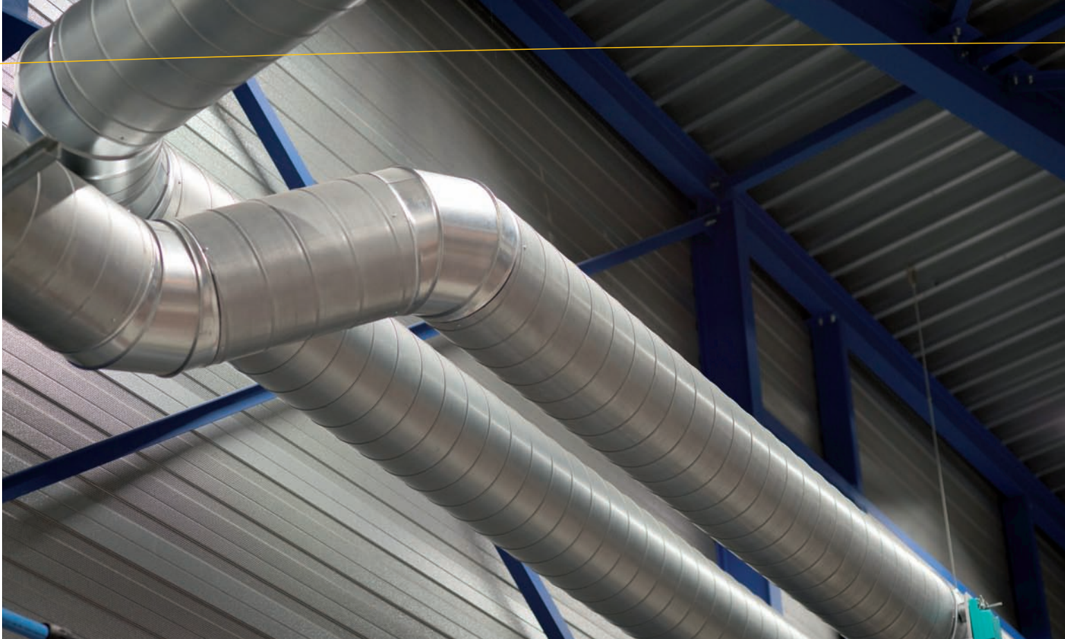
In het nieuwbouwpand van Klift Metaalbewerking zijn de veiligheidsvoorzieningen dik in orde.
